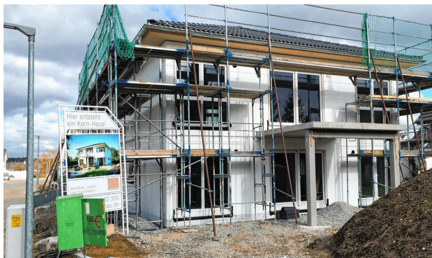
Bei Neubauten haben heute die Themen Energieeffizienz und individuelle Raumaufteilung hohe Priorität. Bild: Privat
